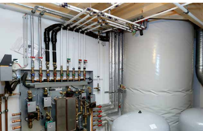
Alternative Wärmequellen konsequent nutzen
